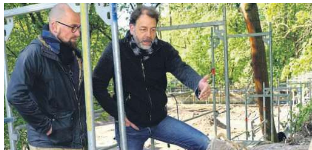
Problem an der Stützmauer am Schwächenteich: Dirk Osmers (HAZ Kassel) zeigt Stadtbaurat Frithjof Look (links) die Baumwurzeln in der Mauer.
